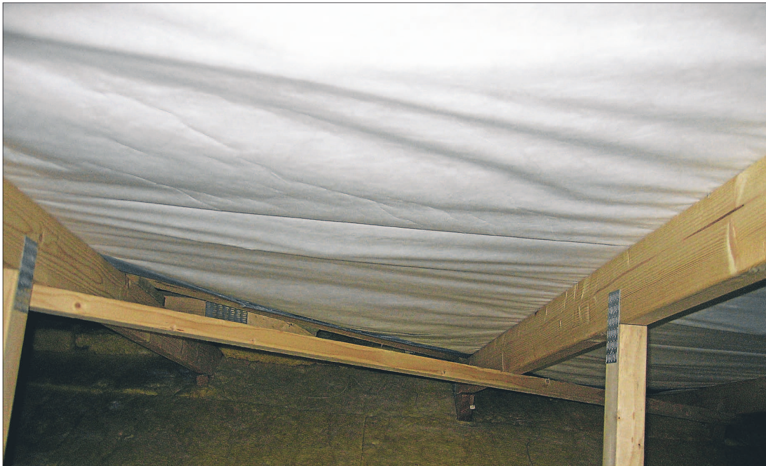
Undertag, der ikke er strammet rigtigt op.
